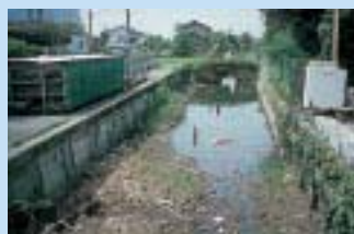
汚れた一般水路
